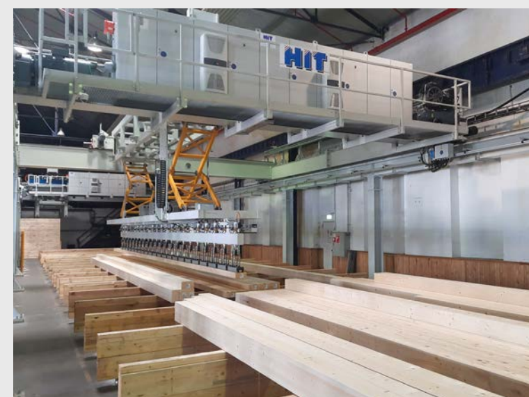
■ Portal PKA - im Hintergrund das Paketportal PKP
